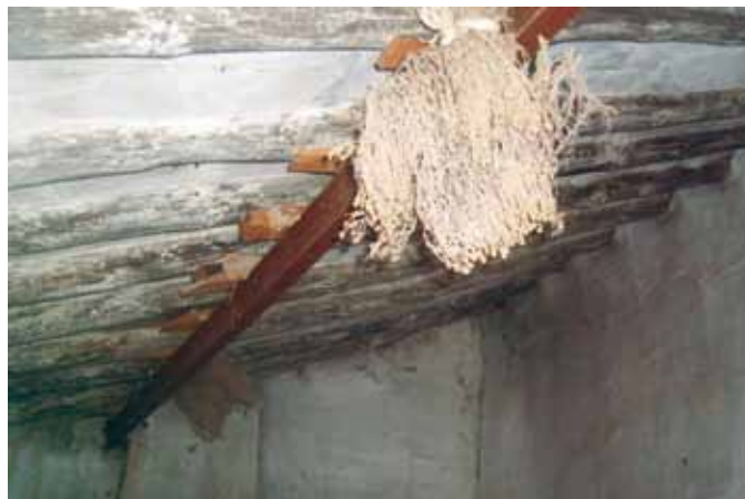
Estado del techo del edificio antes de la rehabilitación
