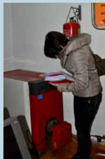
▲ Revisión de caldera en el Ayuntamiento.
